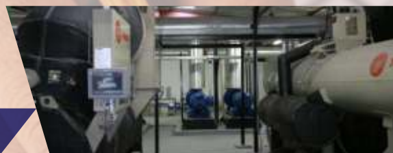
EXAUSTÃO , PRESSURIZAÇÃO E VENTILAÇÃO
